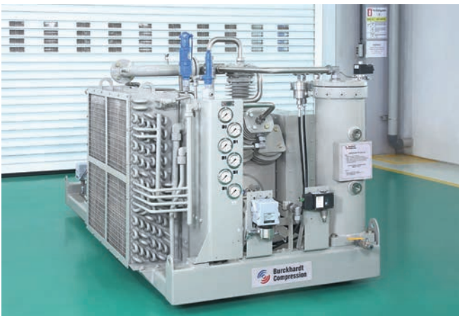
CU compressor package
